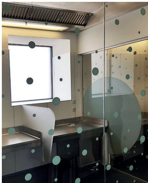
Salle d'inhalation / de fumée supervisée avec bouches d'extraction d'air, Copenhague, Danemark
